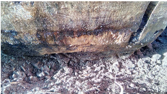
Bodenbereich mit leichten Durchfeuchtungen
